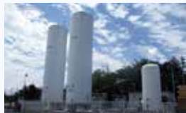
▲液化天然ガスの貯蔵タンク
