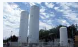
▲液化天然ガスの貯蔵タンク
