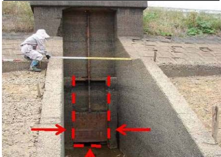
写真 34：ゲート周りの漏水
