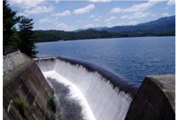
写真3：洪水吐 (香川県HPより)
