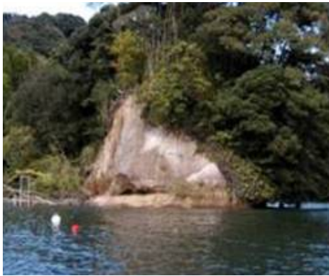
写真 37：貯水池斜面の崩落
