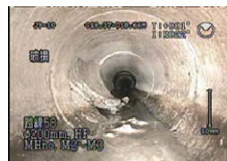
管渠破損状況
