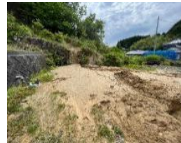
土砂被害の様子
