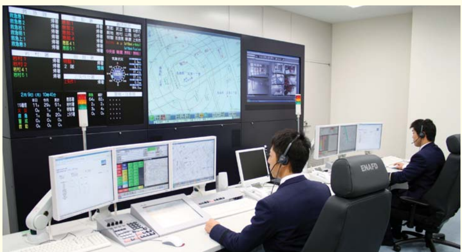
最先端の通信技術を駆使した消防指令センター
