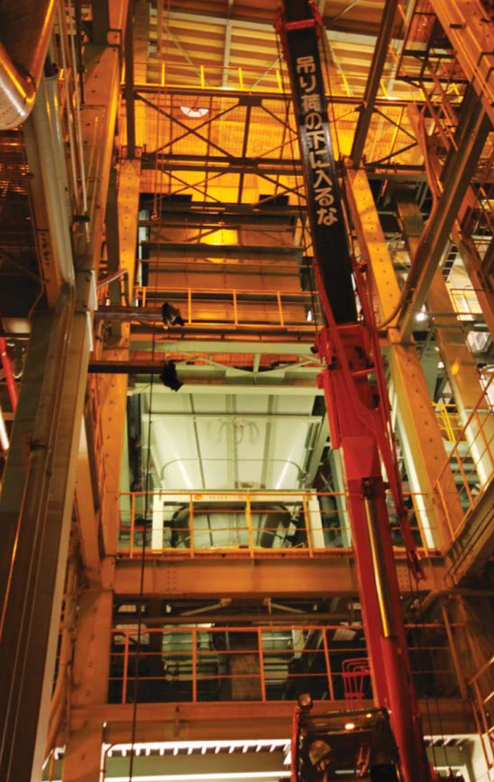
▲成形品貯留サイロ。エコセンター恵那の内部では、多くの機械が設置されている。これらは、全市のごみを処理するため、能力アップの工事が行われている。改修工事は、9月、10月、来年2月の3回に分けて行われる
