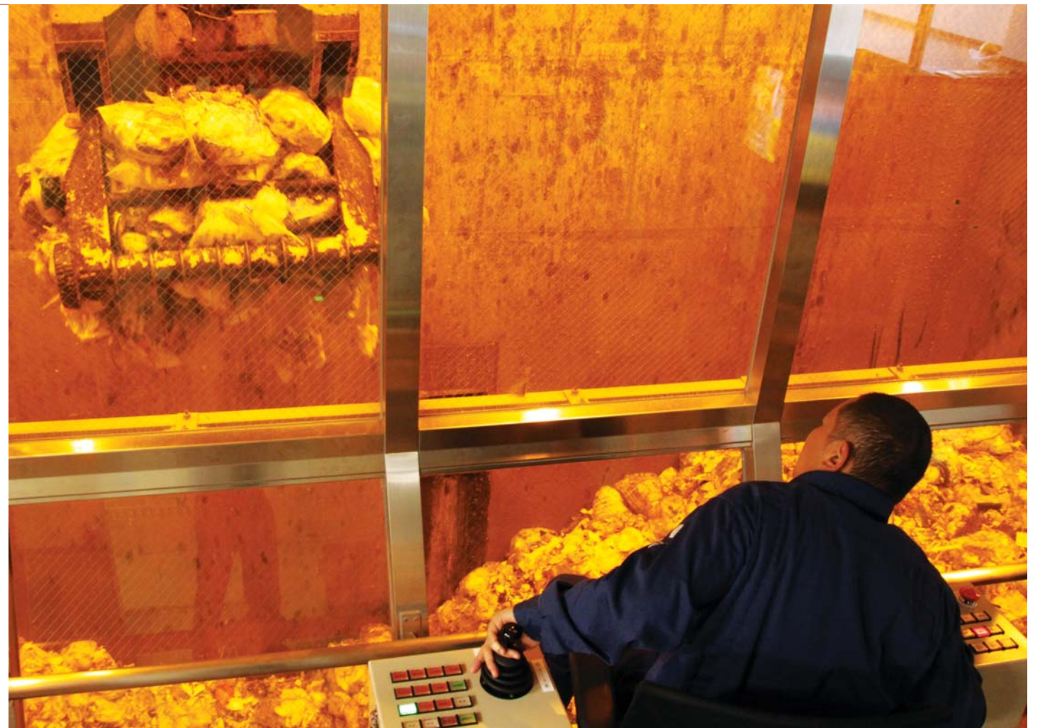
▲エコセンター恵那内のごみビットと呼ばれるところ。市内で回収されたごみは、まずここに集められ、ごみクレーンで受入ホッパに投入され、さまざまな工程を経てRDF炭化物となる。ごみクレーンは、ひとつかみで約1トのごみを投入する
