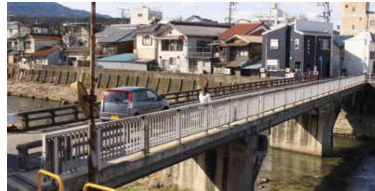
▼恵那駅付近の阿木川に架かる老朽化した神ノ木橋
