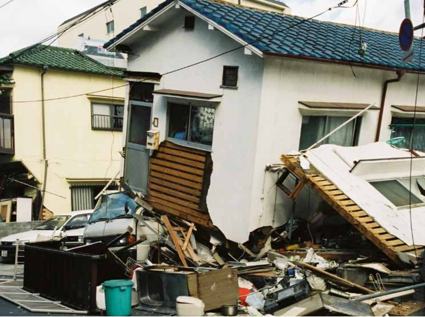
▲地震によって倒壊した家屋。写真は平成7年に発生した阪神淡路大震災のもの
