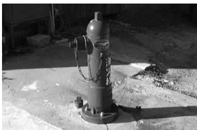
▲地上式消火栓
