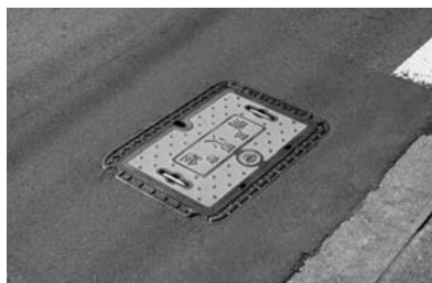
▲地下式消火栓
