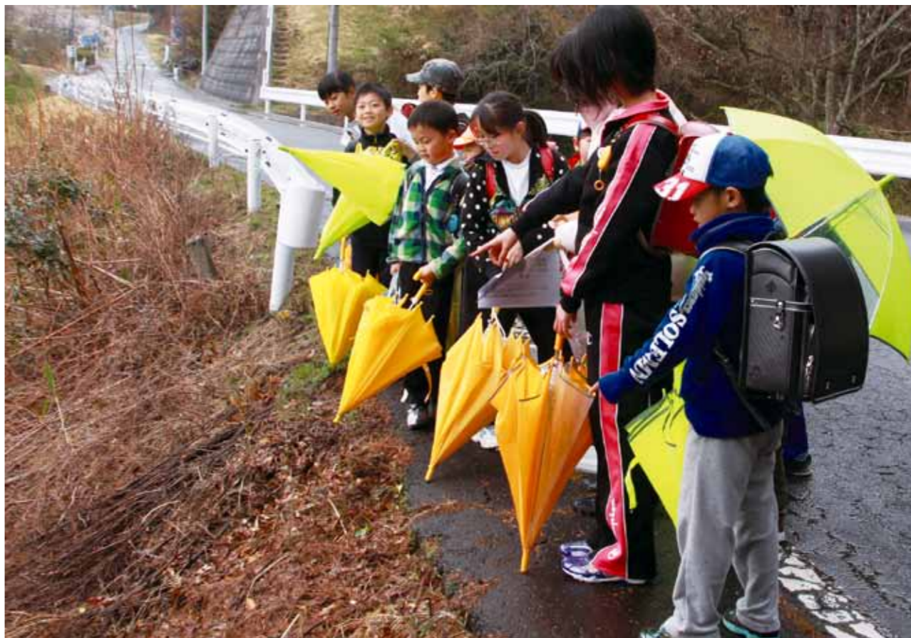
▲飯地小の児童らが通学路のすぐ脇の危険な斜面を確認
