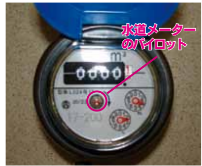
水道メーターのパイロット
