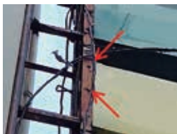
ボルトの緩み
