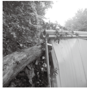
▲倒木で破損した倉庫
