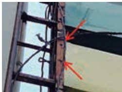
ボルトの緩み
