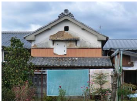
修理事例(修理前)
