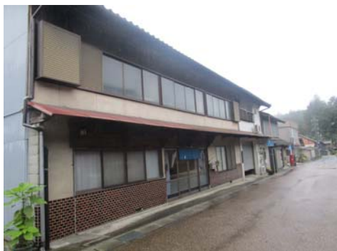
修理事例(修理前)
