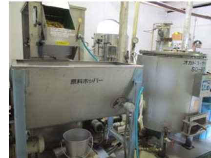
給食センター生ごみ乾燥装置
