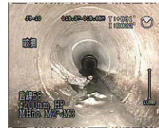
奥戸処理区管渠破損状況
