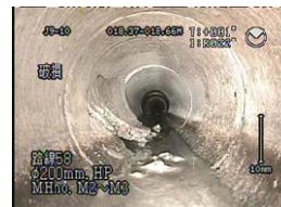
管渠破損状況
