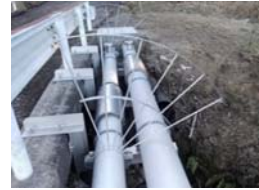
耐震化後の水道管
