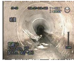
管渠破損状況
