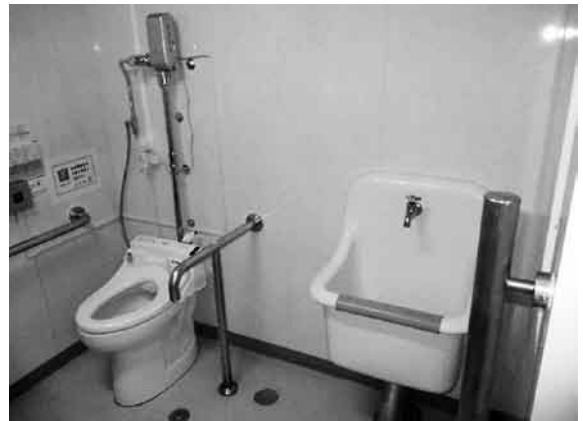
恵那市福祉センター3階トイレの オストメイト用設備
