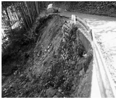
被害を受けた市道上矢作町47号線
