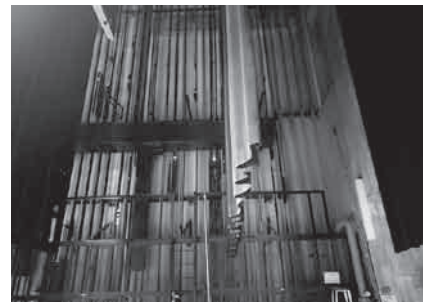
舞台吊物設備
