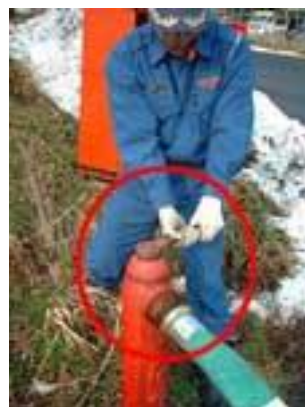
地上式消火栓
