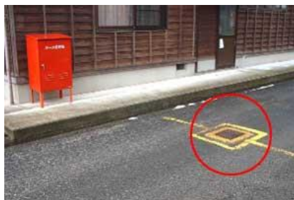
地下式消火栓
