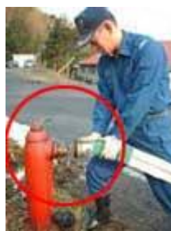
地上式消火栓
