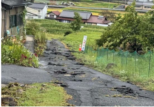
市道中野方町47号線 路面崩壊
