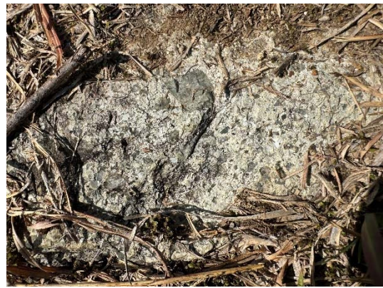
図4 新鮮な岩の色調を露呈する剥離箇所
