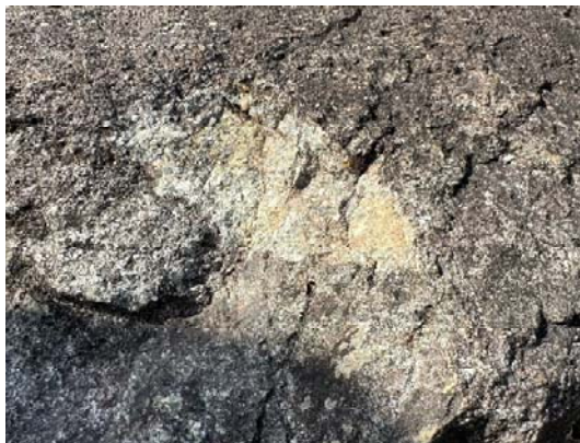
図3 表層剥離箇所
