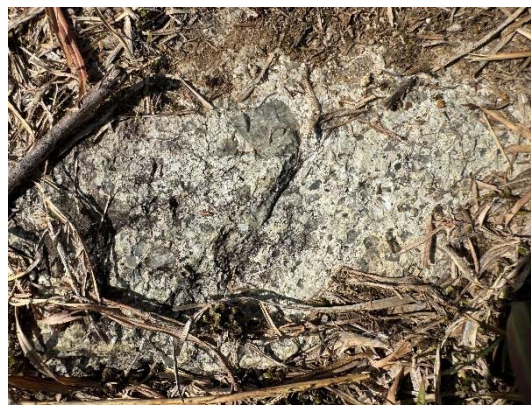
図2 新鮮な岩の色調を露呈する剥離箇所
