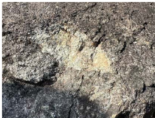
図1 表層剥離箇所
