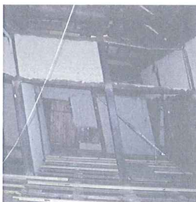
柱や梁が歪んで変形している が倒壊しない事例
