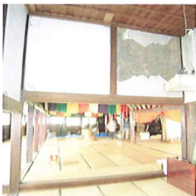
壁が被害を受けているが 柱や梁は被害がない事例
