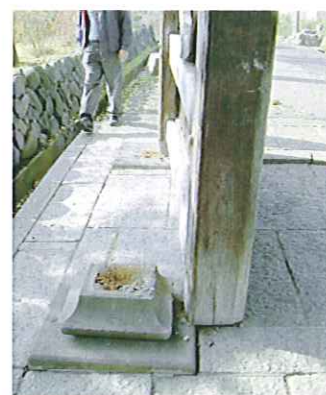
礎石から柱が外れている が倒壊しない事例
