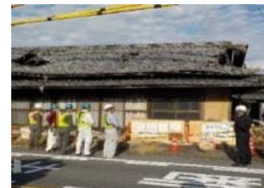
危険性の高い空き家
